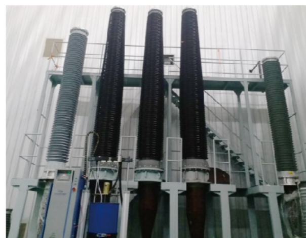
Стенд сборки ввода с фарфоровой оболочкой
